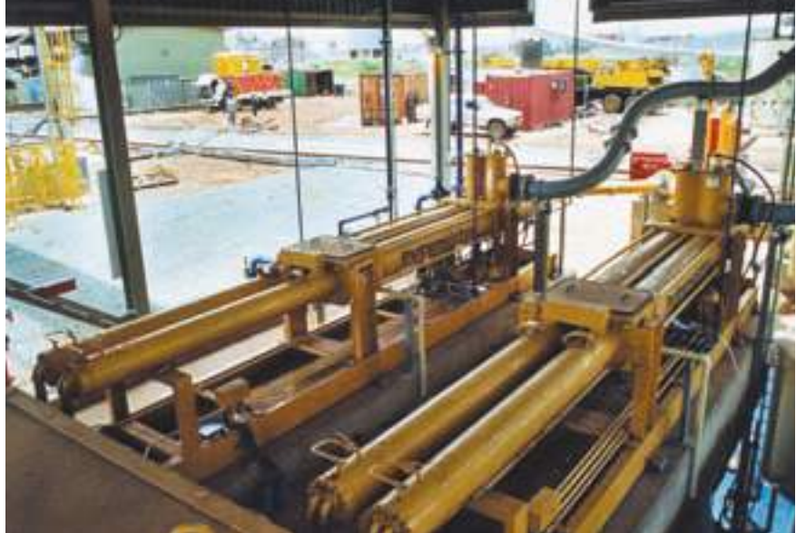
Dos bombas HSP 25100 transportan estériles en la mina de oro en Bulyanhulu en Tanzania
