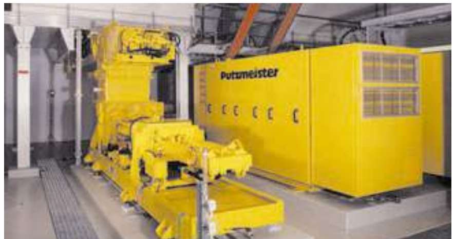
Incineración de lodos de carbón en la central termoeléctrica de Zolling: Bomba industrial KOS 2180
