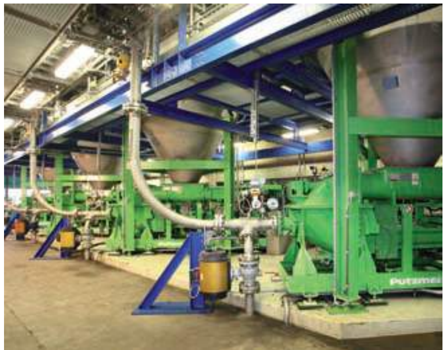
Bomba industrial KOS 1050 en la planta depuradora de ProRheno (Basilea/Suiza)
