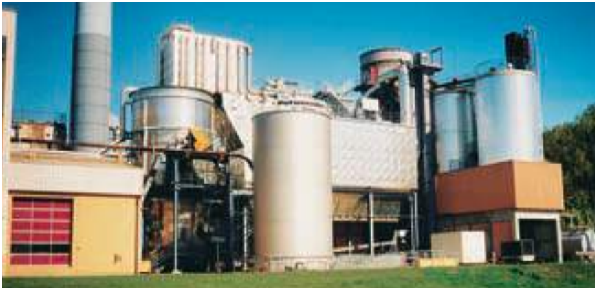
Estación de recepción de lodos activados, que consta de un silo de entrada y almacenamiento para la combustión de los lodos de otras depuradoras en la central Stuttgart-Mühlhausen (Alemania)
