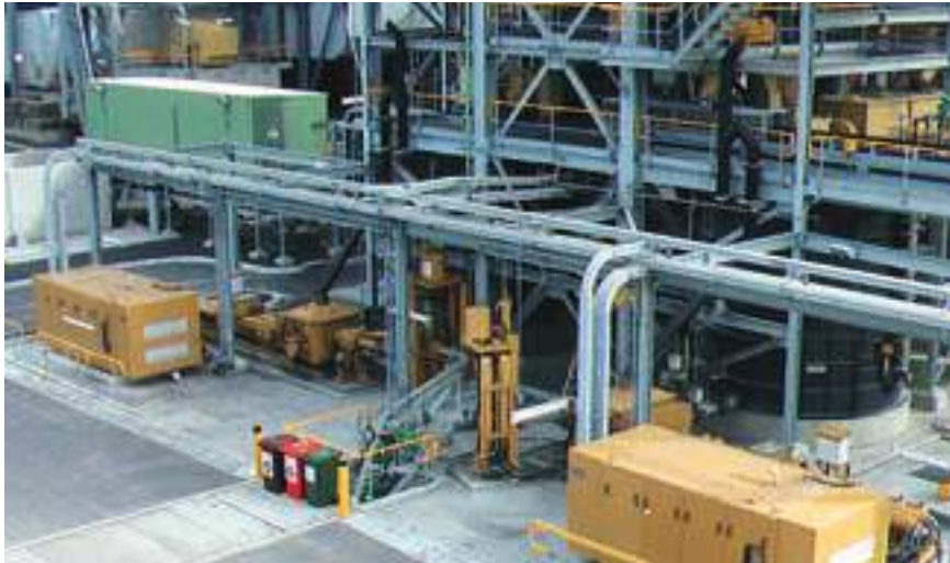
Cenizas volantes y de fondo de horno, unidad de bombeo KOS 25100 (Kogan Creek, Australia)
