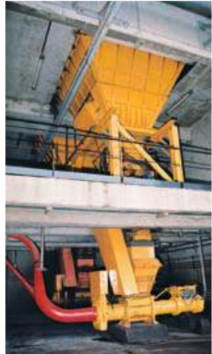
Entrada de residuos sólidos cribados con la bomba EKO 14100 en el horno de Tredi Salaise
