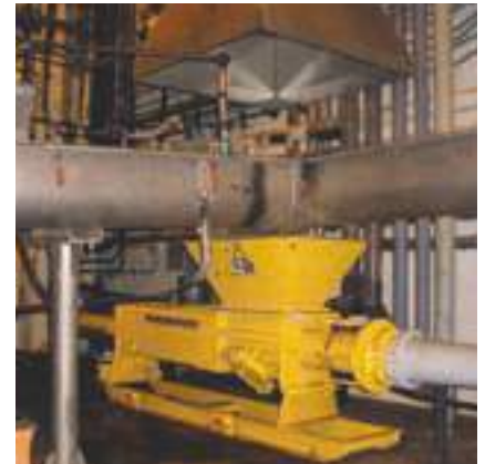
Bombeo de rechazos de criba en Coney Island, Nueva York
