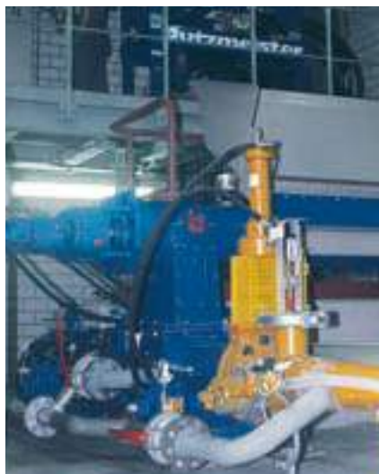
Instalación de bombeo de la industria papelera en una central termoeléctrica
