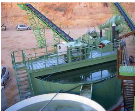
▲ Decantador 8 m Ø con cuba de aguas claras 8 m Ø
